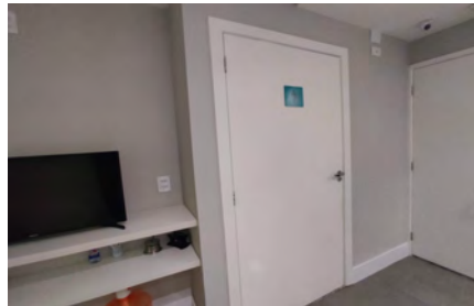
Recepção 1(43) Parede com pintura com manchas aparente
